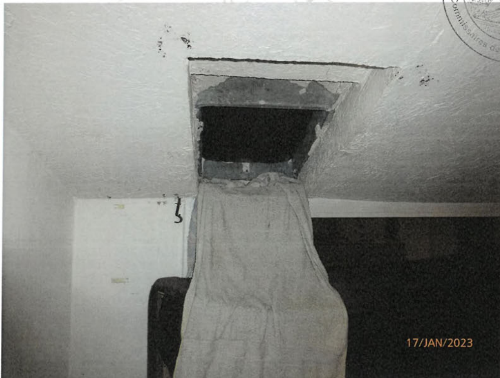
Photo 20 – Velux manquant avec infiltrations
