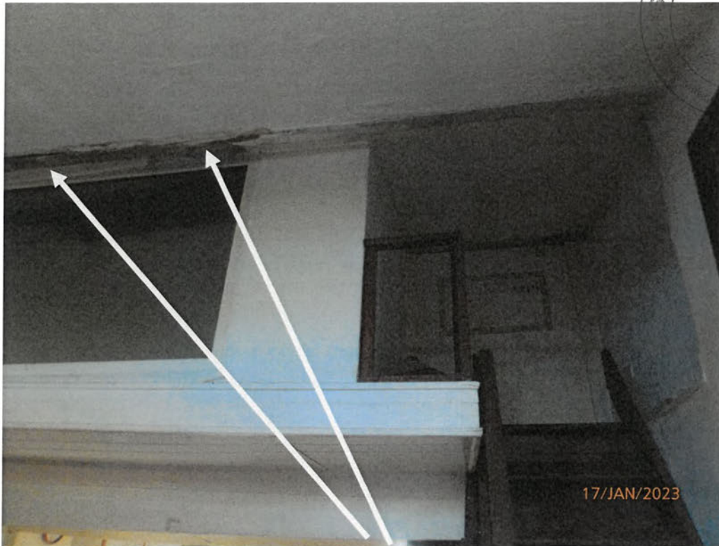
Photo 21 – Vue sur la dégradation de la poutre
